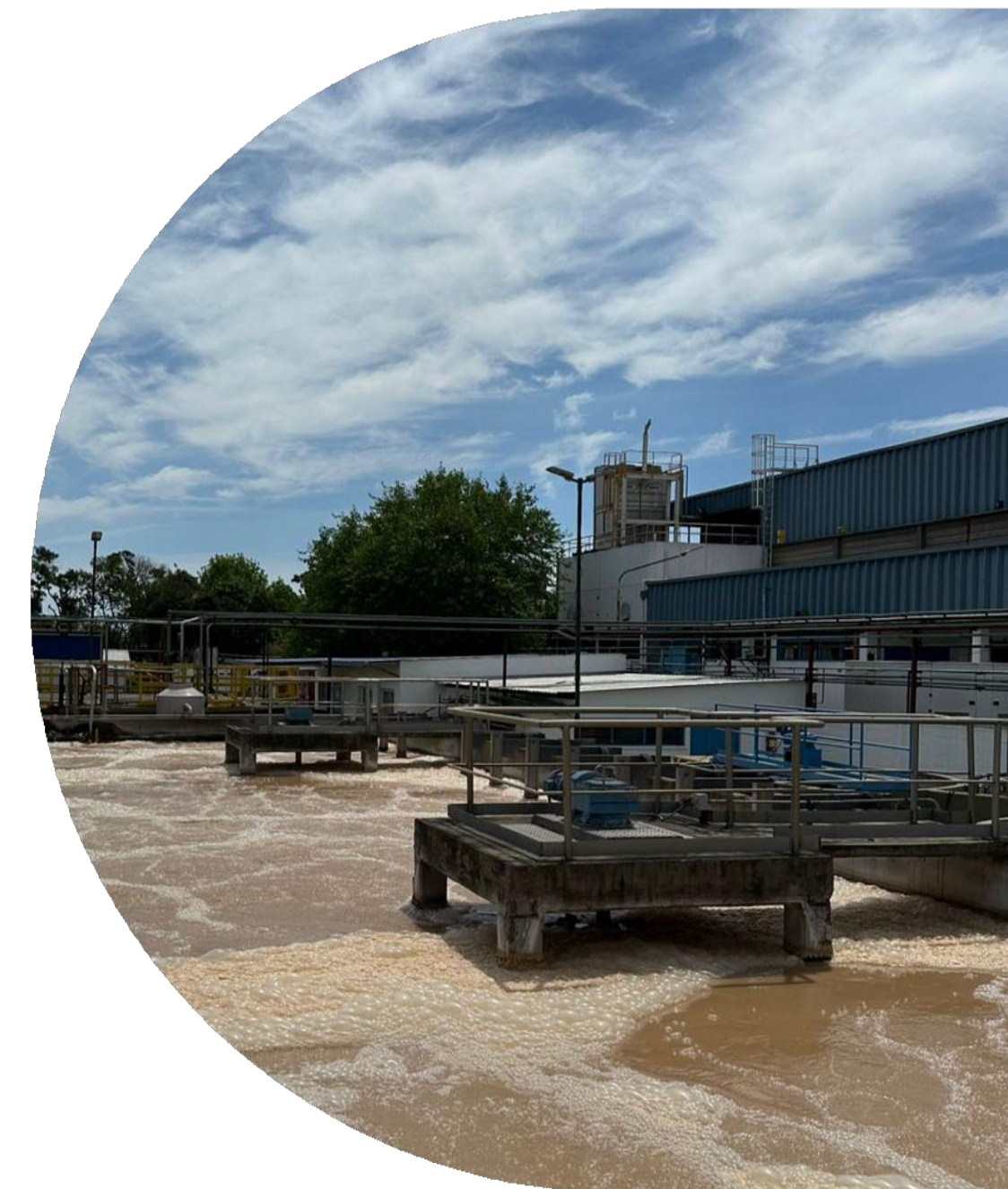
Planta de Tratamiento de Efluentes Líquidos por barros activados.
